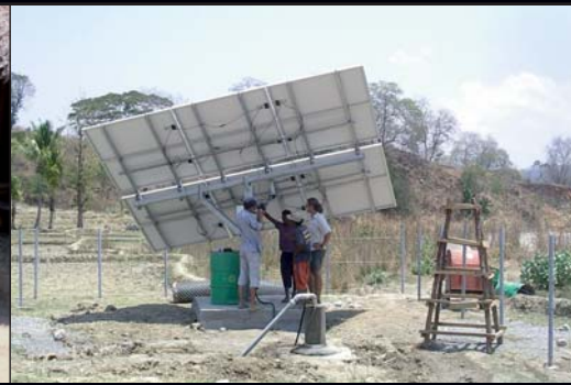
Système solaire, Cauiri / Solar system, Cauiri © CB/TGH
